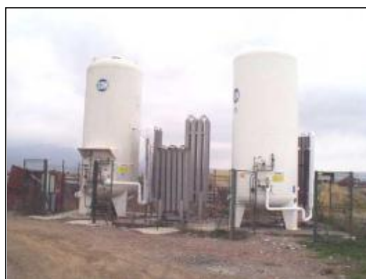
Serbatoi di ossigeno liquido
