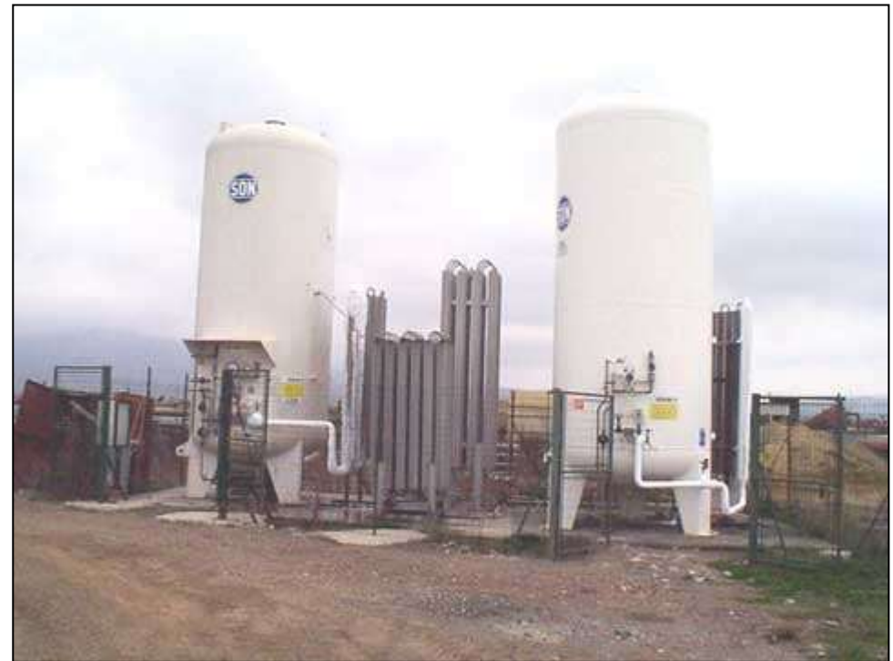
Serbatoi di ossigeno liquido
